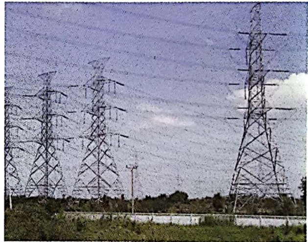
เสาไฟฟ้า
