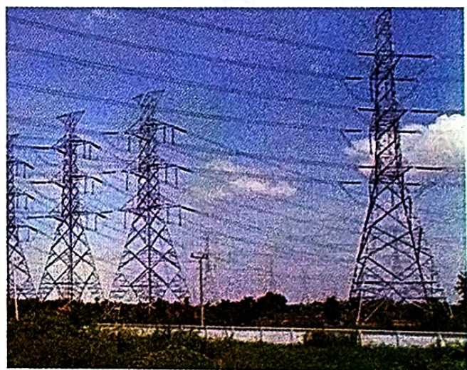
เสาไฟฟ้า
